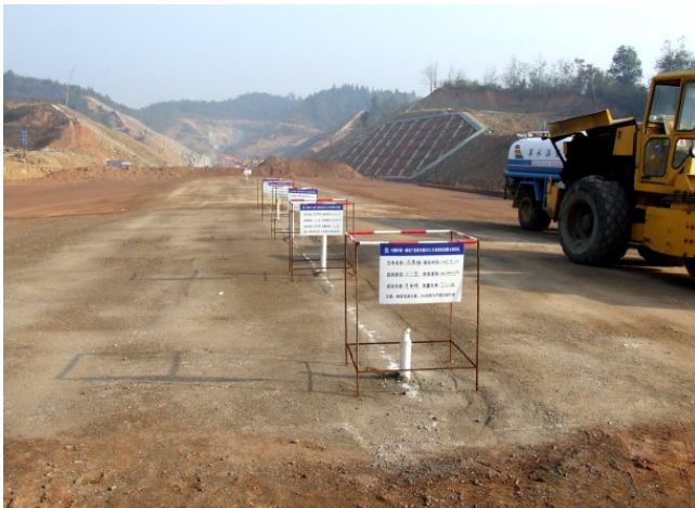
Bild 7: Setzungsmesseinrichtungen in einem Damm
