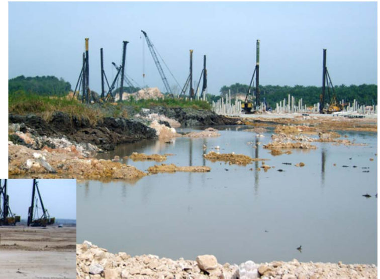
Geländeauffüllung mit mürbem Felsbruch
