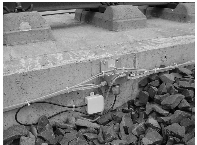
Bild 10. Messgeber an der Festen Fahrbahn
